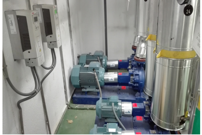
Grupos de bombas
